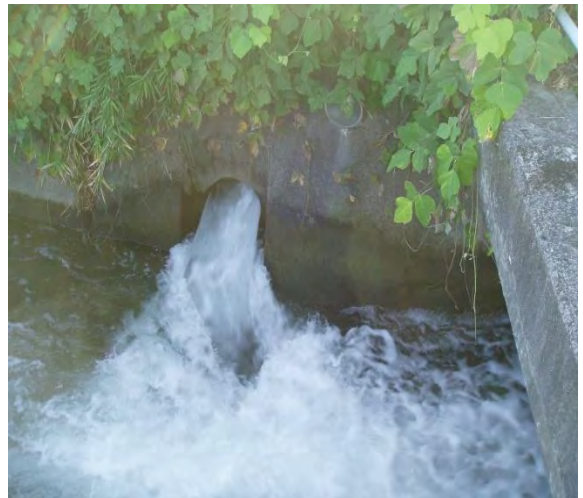
KIOXIA 旧棟からの排水：部田川へ
