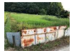
トタン板の防除柵
